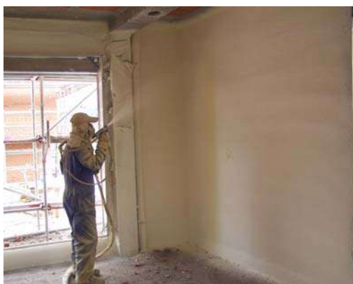
Detalle de aplicación de Proyección de espuma de Poliuretano de celda cerrada
